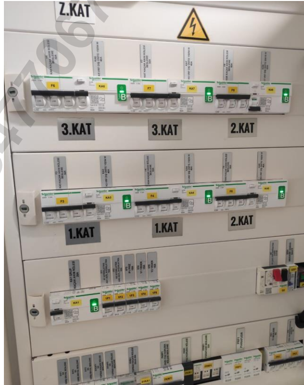
Resim 82. Elektrik Panosu Üzerinde Etiketleme Örneği
