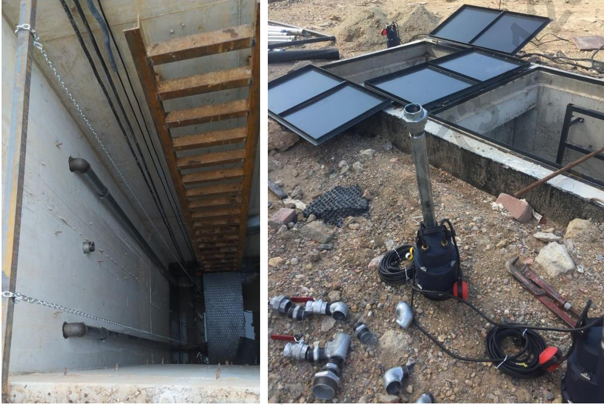
Resim 13. Pis Su Terfi İstasyonu Mekanik Bağlantı Ve İmalat Örneği
