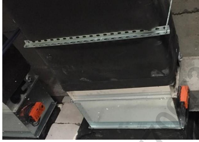
Resim 60. Klima Santrali Havalandırma Kat Girişlerindeki Servo Motorların Bağlantı Örneği
