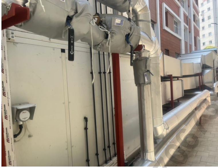
Resim 58. Klima Santrali Mekanik İmalat Örneği
